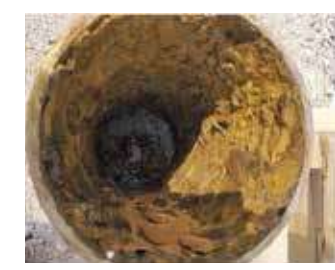
▲老朽化した水道管
