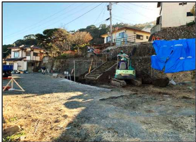
2月の主な工事内容 掘削工事→擁壁(ブロック積み)基礎工事
