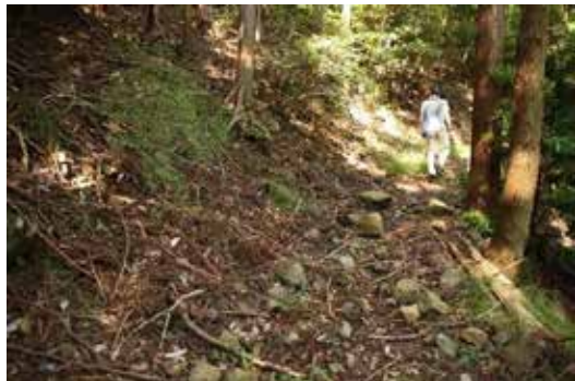
見学路の崩れ
