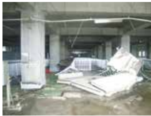
浄水管理センター被害の様子
