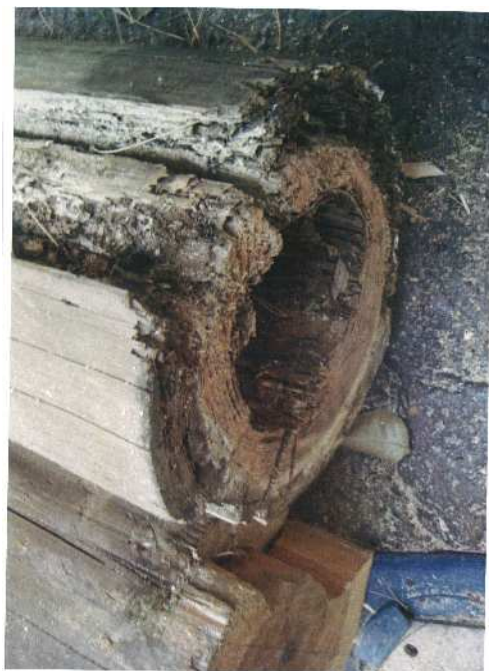
写真-1 柱の腐食状況
