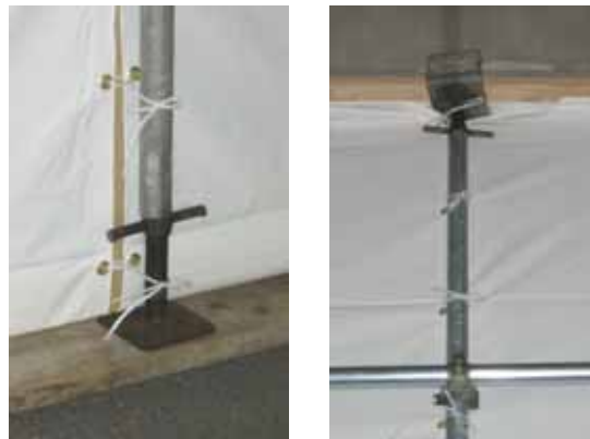
図表 3-47 防災シートの固定詳細 (左:足元。単管にベースジャッキを挿入。左:頭部。単管に根太受け金物を挿入)
